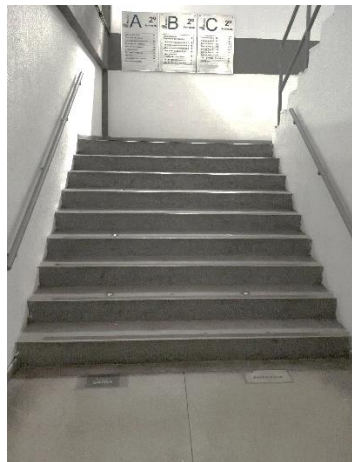
Figura 64 - Escada sem corrimão duplo e piso tátil na entrada e saída
