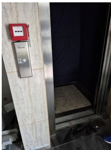
Figura 70 - Elevador sem piso tátil
