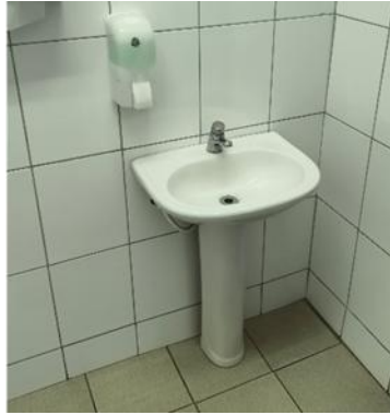
Figura 56 - Lavatório com coluna
