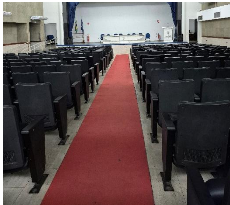
Figura 76 -Corredor sem piso tátil (Auditório 1)
