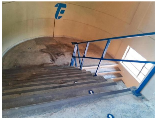
Figura 67 - Escada sem corrimão arredondado e sem piso tátil
