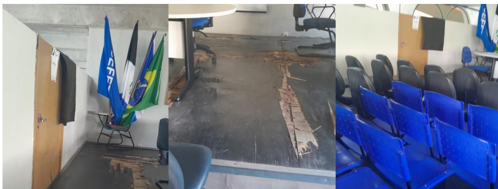
Figura 78 - Cadeiras fora do padrão, sem espaço de circulação, palco sem rampa e fora do padrão
