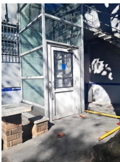
Figura 71 -Plataforma elevatória sem demarcação
