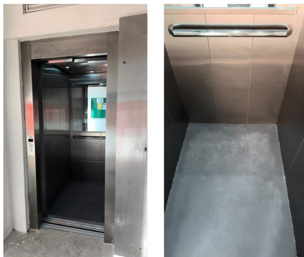
Figura 73 - Elevadores sem piso tátil junto à porta e fora das dimensões
