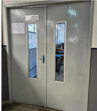
Figura 50 - Sinalização com altura incorreta
