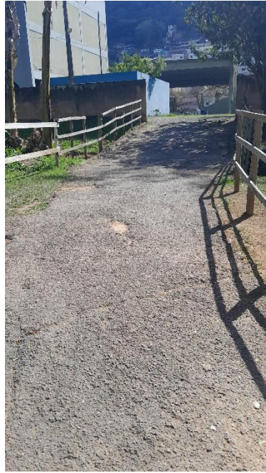
Figura 63 - Rampa de acesso ao Bloco C. Piso trepidante e irregular
