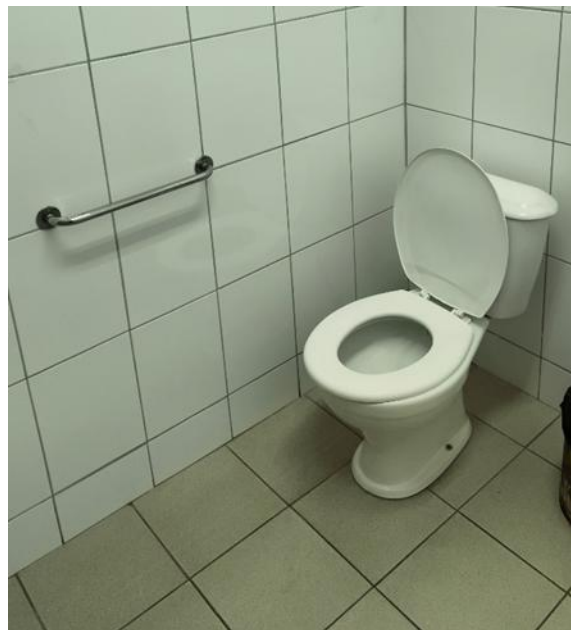
Figura 55 - Barras de apoio e descarga fora do padrão
