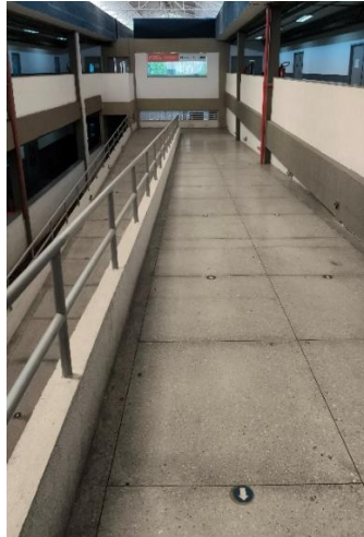
Figura 65 - Rampa sem piso tátil
