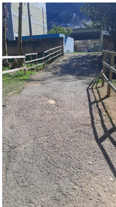
Figura 9 - Rampa de acesso ao bloco C. Piso trepidante e irregular.
