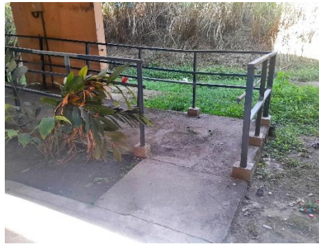
Figura 66 - Rampa sem piso tátil e piso irregular
