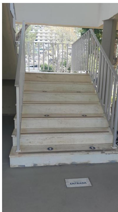
Figura 62 - Escada sem piso tátil na entrada e saída, sem corrimão duplo com acabamento curvado
