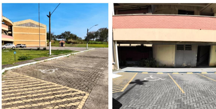
Figura 12 - Estacionamento Nova Iguaçu sem vaga para idosos e com superfície irregular
