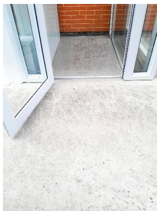
Figura 72 - Plataforma sem demarcação e fora das dimensões (Bloco B)
